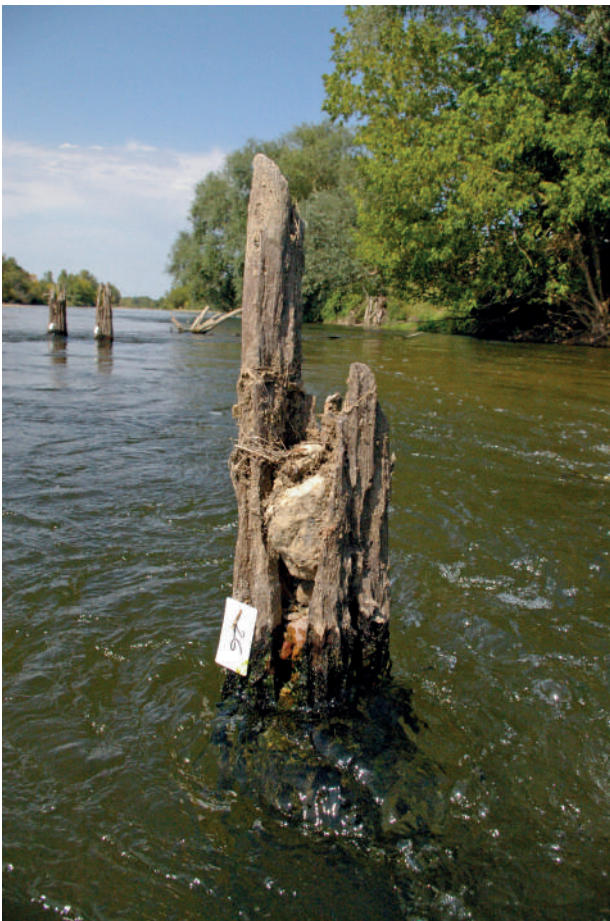
Les bois de fondation du pont médiéval de La Charité-sur-Loire sont très dégradés par les périodes de sécheresse. Les parties facilement accessibles ne sont plus exploitables pour les analyses dendrochronologiques / Periods of draught have caused severe damage to the wooden foundation of the medieval bridge of La Charité-sur-Loire. The parts that are easily accessible no longer provide usable samples for dendrochronological analysis (© P Moyat).
